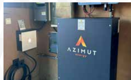
Cette batterie intelligente connectée au réseau permet d'acheter l'énergie quand elle est bon marché, pour la redistribuer lorsqu'elle est plus chère.
