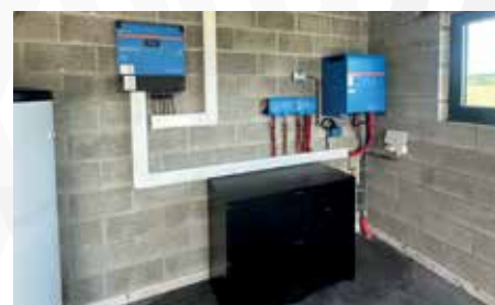
Une installation pour une maison 100% hors réseau dans la région d'Habay
